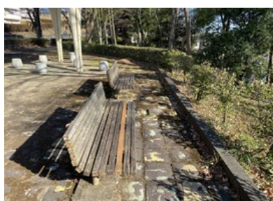
写真2 公園施設の老朽化
